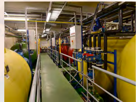
Anlage zur Behandlung radioaktiver Abwässer
