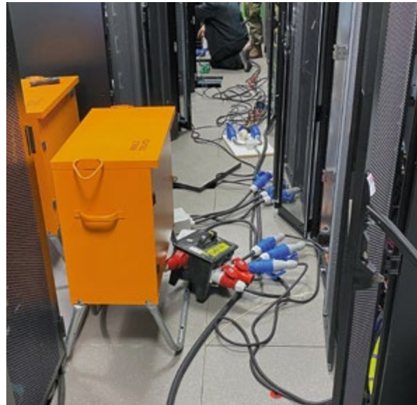
△ Abb. 4: Alternative Stromversorgung für die Server. (Quelle: ZGeoBw)
