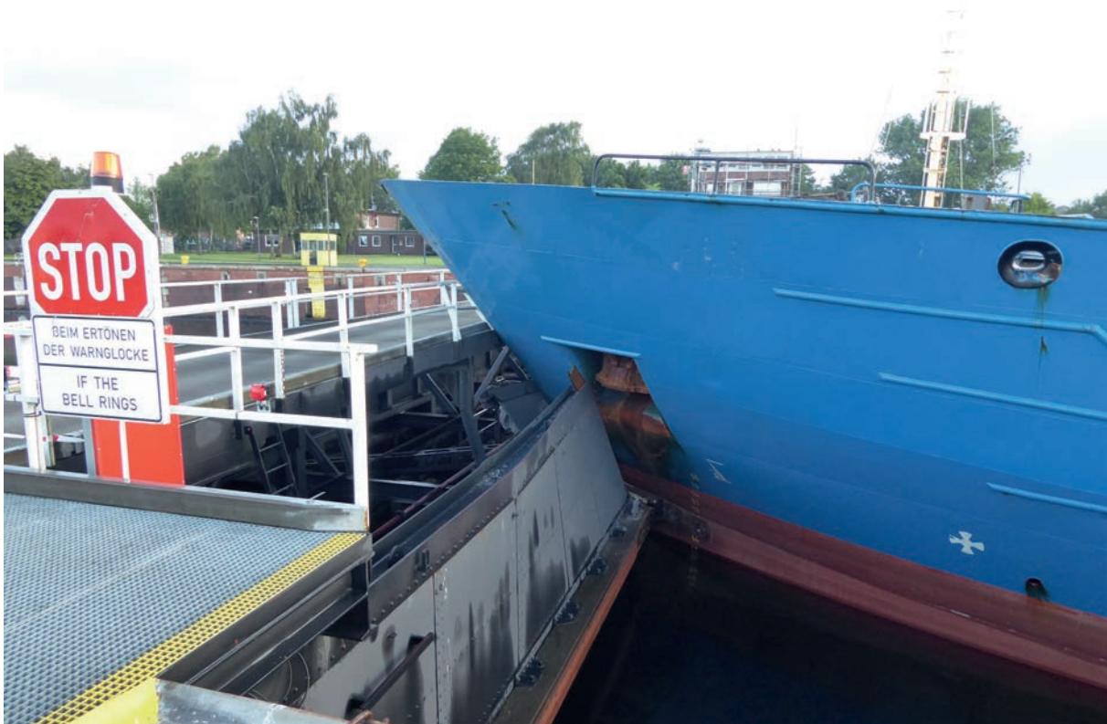
Beschädigtes Schleusentor in Kiel-Holtenau
