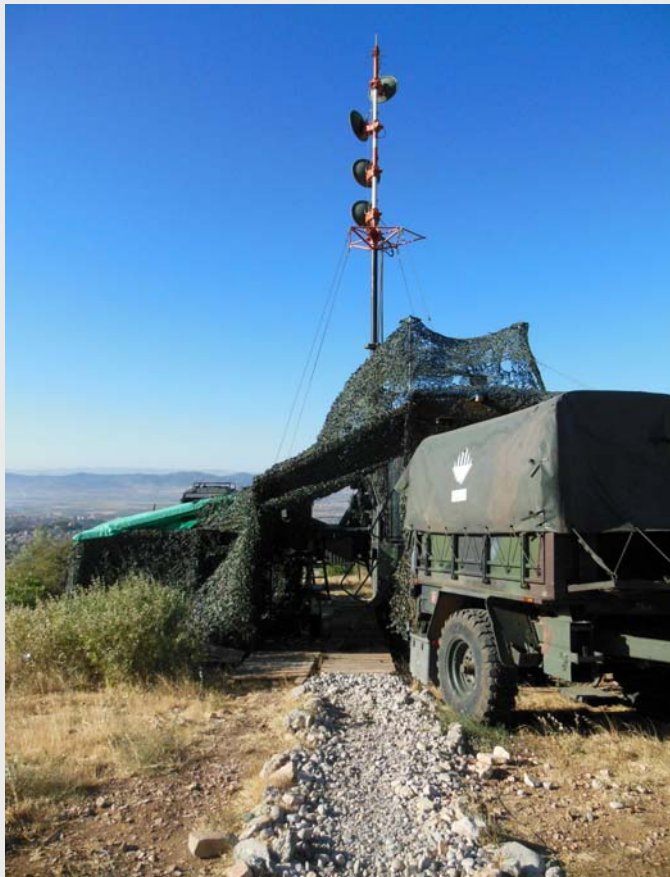
AF TUR: Richtfunkanlage auf dem „Comms Hill“, dem höchsten Punkt der gesamten Stellung (Quelle: Bundeswehr)
